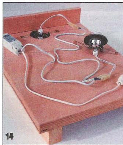
Прежде чем установить крышку на место, в отверстие встраивают светильник, крепят трансформатор и прокладывают провод. Крышка — выдвигаемая, что обеспечивает доступ к светильнику в любое время.
