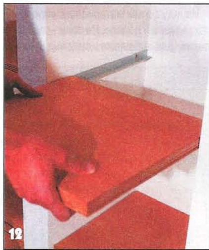
Пазы выбирают ближе к нижней поверхности крышки или полки, чтобы её боковые кромки были достаточно прочными. Крышка будет скользить по скрученным алюминиевым уголкам.
